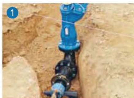
Jednostavno priključenje na hidrante.
